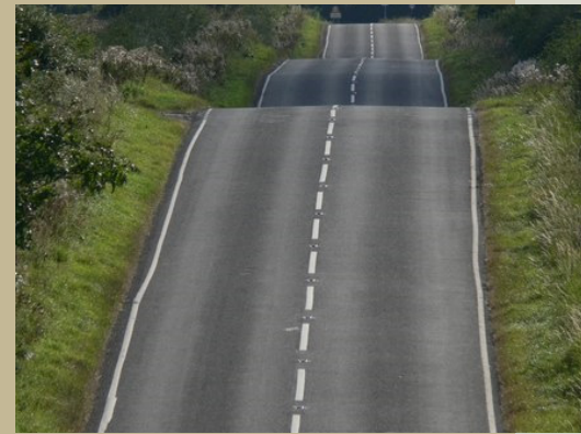
Fig. 4 - Ondulações sucessivas no perfil longitudinal de pavimento, aspecto compatível com deformações diferenciais do subleito. Em depósitos profundos e heterogêneos de solos moles, o controle insuficiente das deformações resulta em recalques diferenciais e perda progressiva da regularidade da via.
