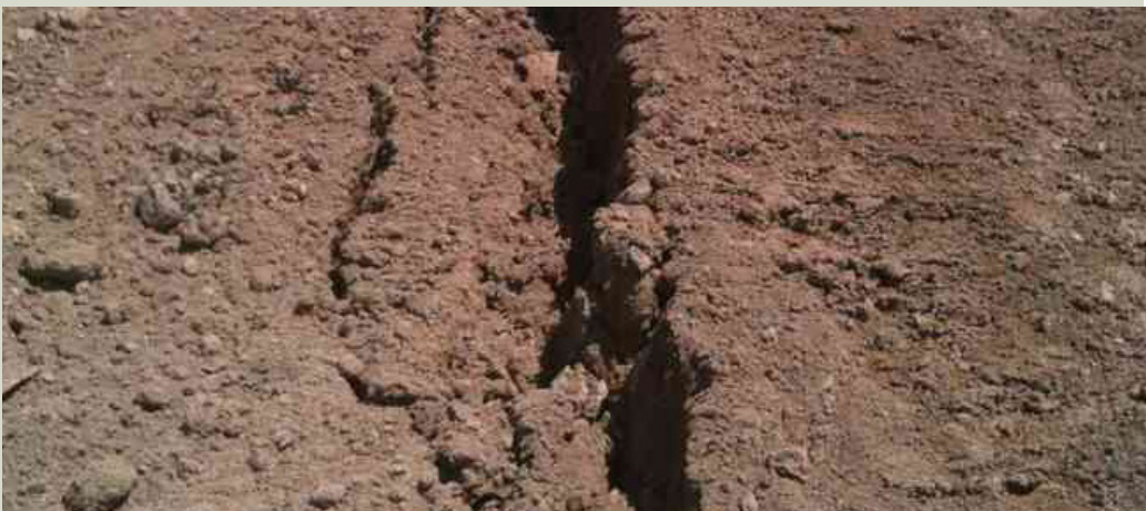
Fig. 4 - Fraturamento longitudinal de grande abertura desenvolvida em aterro durante a fase de construção, evidenciando deslocamentos diferenciais associados à perda de estabilidade do maciço. Este tipo de manifestação é um importante indicativo de deformações progressivas em fundações sobre solos moles, exigindo monitoramento contínuo e a adoção imediata de medidas de melhoramento do solo para evitar a evolução para processo de ruptura.
