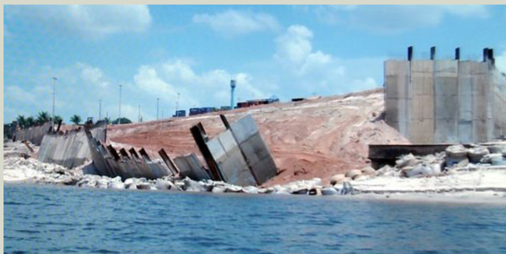
Fig. 5 - Colapso de estrutura de contenção durante execução de aterro sobre solo mole. A ruptura evidencia a elevada sensibilidade de soluções estruturais com estaqueamento quando o ganho de resistência do subsolo não acompanha a velocidade de alteamento do aterro. O excesso de poropressões e a baixa rigidez da fundação desencadeiam grandes deslocamentos laterais, culminando no colapso da estrutura e do maciço. Casos como este reforçam a importância do melhoramento do solo, do controle da sequência executiva e do monitoramento geotécnico contínuo ao longo da construção.
