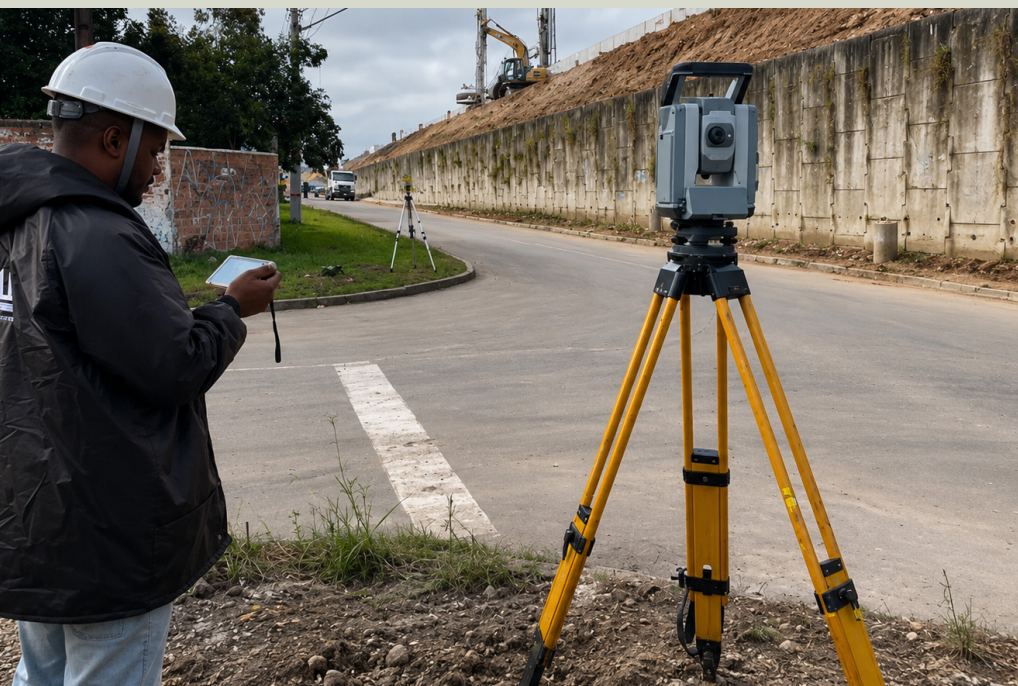
Fig. 19 - Essa foto comunica muito bem um aspecto que vem se tornando indispensável em obras geotécnicas modernas: o monitoramento instrumental em tempo real, tão importante quanto executar. Durante a construção, equipamentos de alta precisão acompanham continuamente qualquer deslocamento do terreno e das estruturas. Este controle permite confirmar que o solo está respondendo conforme o previsto em projeto, garantindo segurança, qualidade e possibilitando intervenções imediatas, caso seja detectado qualquer comportamento fora do esperado. Estações totais monitoram, com precisão milimétrica, a movimentação do terreno, do muro de contenção e do aterro durante todas as etapas da execução. As informações obtidas em campo são comparadas com as previsões do projeto, permitindo validar o desempenho do melhoramento do solo, assegurando a estabilidade da obra.
