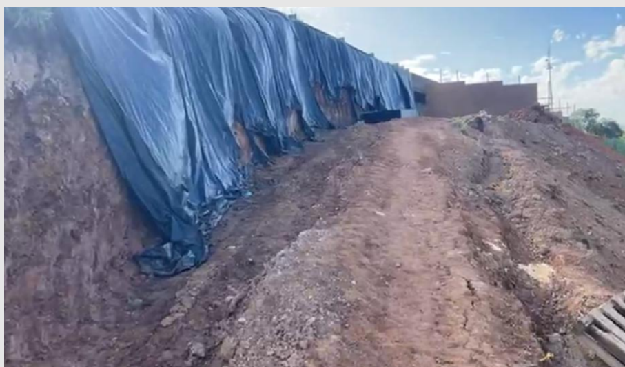
Figura 6 - Corte vertical, no talude rodoviária, coberto com lona, extremamente perigoso e passível de problemas.
