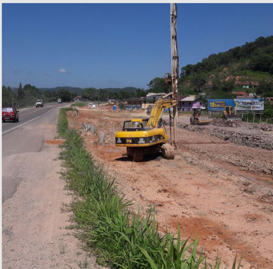
Fig 12 – A importância do melhoramento do solo em uma ampliação rodoviária quando há presença de solos moles.
