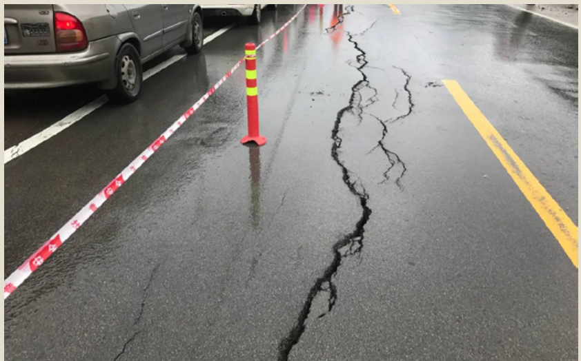
Figura 2 - Trincas longitudinais na intercessão do pavimento antigo com o ampliado.
