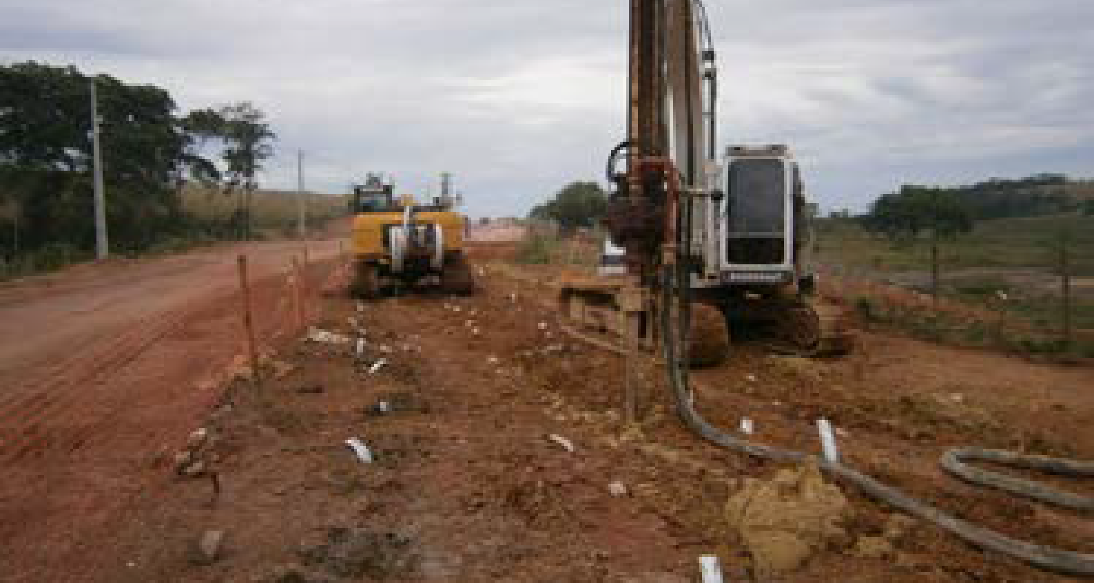
Figura 7 - Nesta rodovia, com presença de solo mole na fundação, executou-se aterro para ampliá-la, ocorrendo, imediatamente, fraturas em sua superfície, evidenciando princípio de rutura. Com esta condição, inciou-se o melhoramento do solo.
