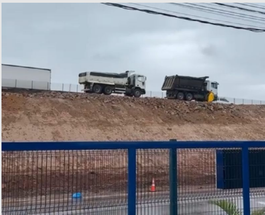
Figura 5 - Corte vertical sendo executado em uma ampliação rodoviária. Possíveis problemas de trincas longitudinais no novo pavimento.
