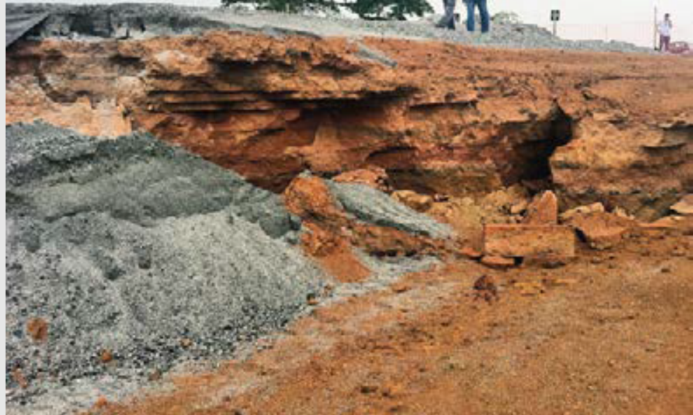
Fig 13 – Rutura em um ampliação estradal onde não foi respeitado a presença de camadas de solo mole.
