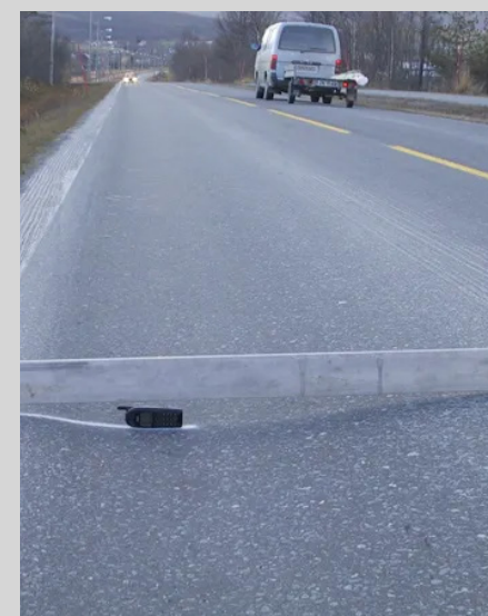
Figura 6 - Trincas com afundamento plástico na região duplicada.
