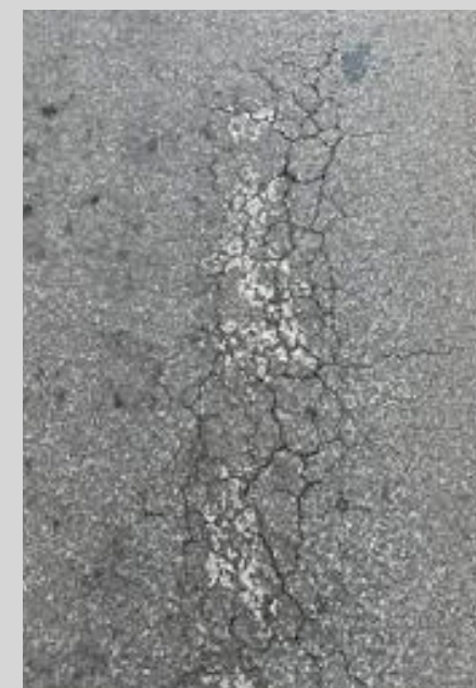
Figura 4 - Trincas em forma de pele de crocodilo na parte duplicada do pavimento.
