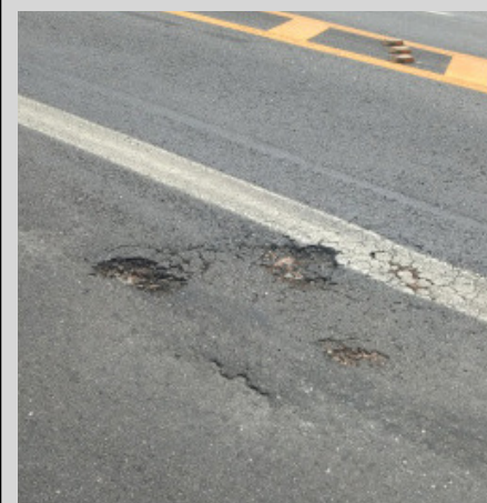
Figura 3 - Trincas de fadiga na parte duplicada do pavimento.
