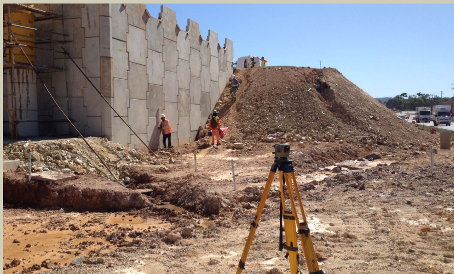
Figura 3 - Aterros de grande altura exigem solo de fundação homogeneizado com melhoramento do solo, de modo a se evitar recalques. O controle das deformações é obrigatório.
