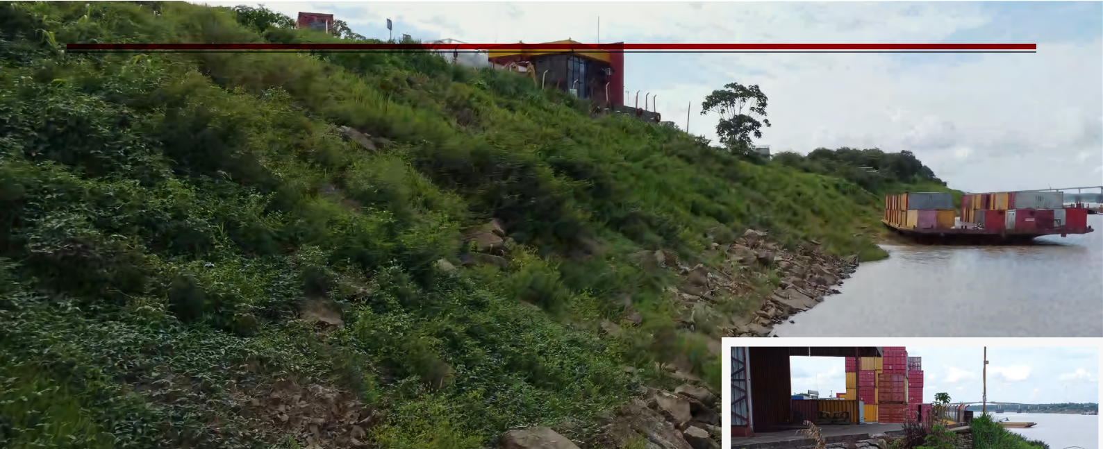
Figura 2 - Talude com histórico de recalques e ruturas devido às condições do solo, do rio e do clima amazônico.
