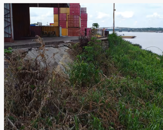
Figura 3 - Taludes íngremes com sinais de ruturas.
