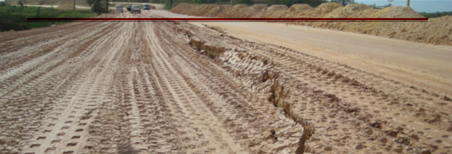
Figura 9 - Nesta ampliação estradal, o aterro estava sendo elevado e, de repente, rutura rápida (não drenada). O motivo foi a solução com pré-carregamento, bastante limitada. O processo de rutura em um aterro estradal, acaba por fragilizar ainda mais o solo de fundação, com diminuição ainda maior de sua resistência, redução do atrito entre partículas e colapso da estrutura de seus poros, não reversível no curto prazo, o que debilita o solo remanescente. O processo de adensamento fica descontrolado, com zonas pouco adensadas, outras sem qualquer consolidação, além de um plano de rutura fragilizante intermediando. O gradiente de poropressões torna-se caótico ou desarranjado, ocorrendo aumentos súbitos, comprometendo o solo adjacente. A condição suporte do solo de fundação fica mais reduzida, ficando susceptível a cargas menores.
