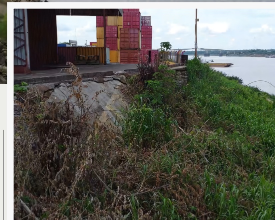
Figura 3 - Taludes íngremes com sinais de ruturas.
