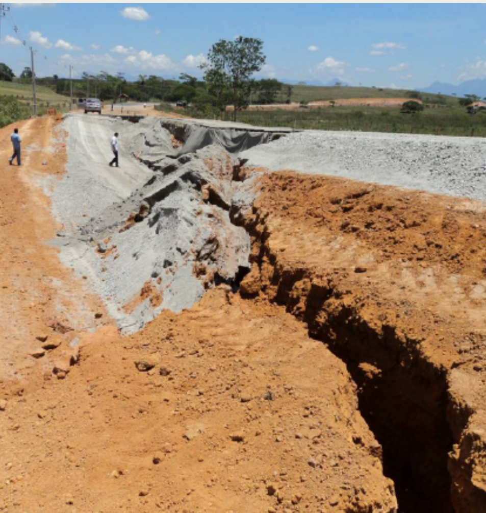
Figura 10 – A utilização do aterro de precarregamento, na duplicação estradal, é extremamente perigosa, já que implica em elevado risco de rutura, quando há presença de solos argilosos moles. Rutura em uma ampliação rodoviária, devido a colocação do novo aterro sobre solo mole, na região nordeste.
