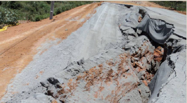
Figura 4 - Utilização de aterro de duplicação sem nenhum critério, desconsiderando a questão da emenda e a presença de solos moles na região, o que implicou em rutura do solo, comprometendo a antiga estrada.
