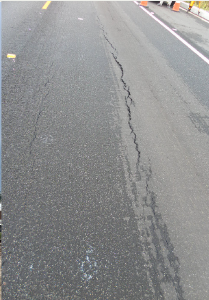
Figura 9 – Trincas longitudinais, ao lado do pavimento ampliado, significando preparação inadequada na região de transição entre o antigo e o novo aterros.
