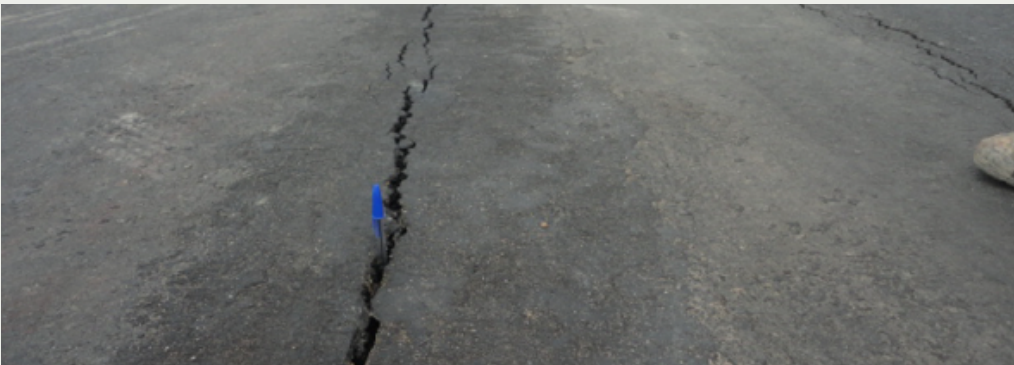
Figura 4 – Trincas longitudinais, ao longo de uma rodovia estadual ampliada. Má preparação da emenda entre aterros.
