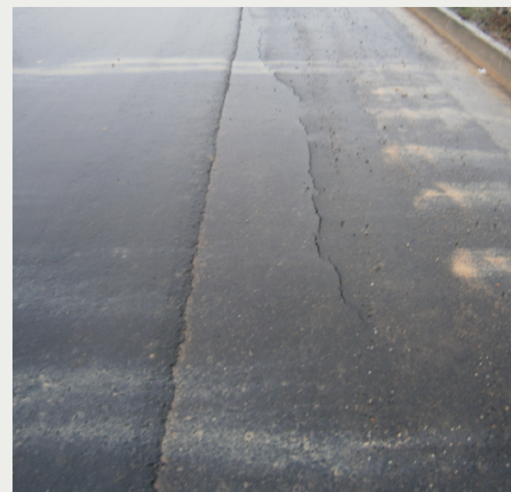
Figura 7 – A região da emenda entre aterros, na duplicação estradal, precisa ser adequadamente preparada, além do melhoramento do solo de fundação quando há presença de solos moles. Trincas longitudinais costumam surgir imediatamente após a conclusão da duplicação.
