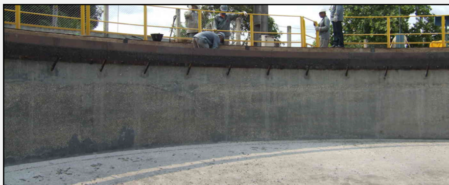
Figura 5 – Grandes estruturas horizontais, quando apoiadas sobre solos moles, necessitam da interação solo-estruturas.
