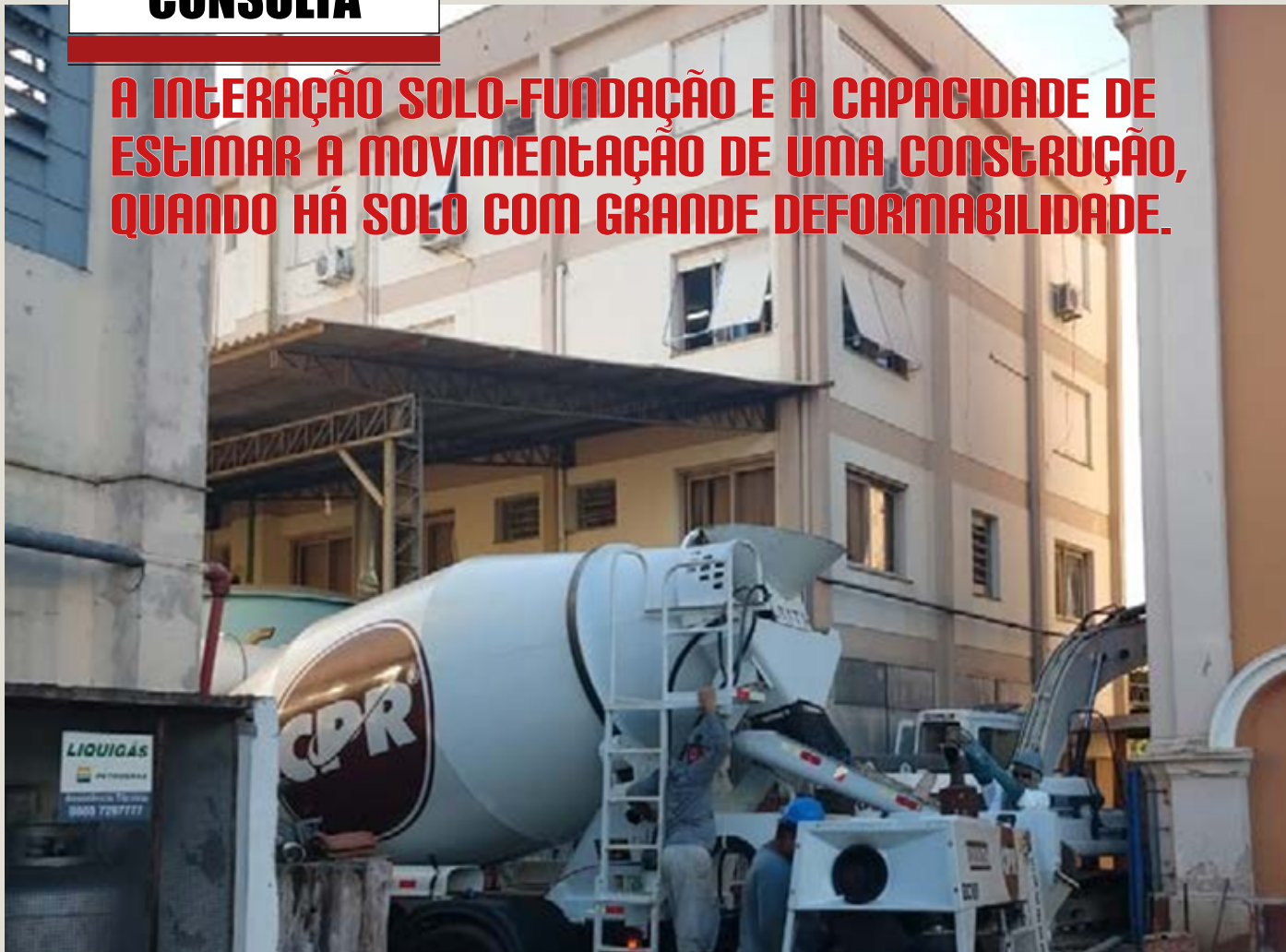
Figura 1 - Neste centenário prédio, situado em Porto Alegre, RS, construído sobre solo mole e com fundação direta. Houve a necessidade de readequação do solo de fundação com melhoramento do solo.
