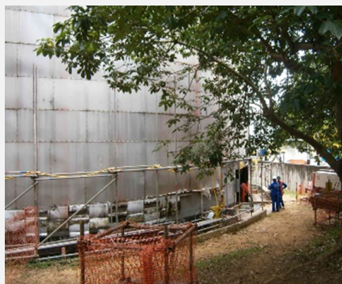
Figura 13 - Borda de um tanque industrial de combustível. Fundações em tanques industriais geram recalques diferenciais, pelo desconhecimento da interação solo-estrutura. O melhoramento do solo, homogeneizando-o para as tensões desejadas costuma ser a melhor solução.
