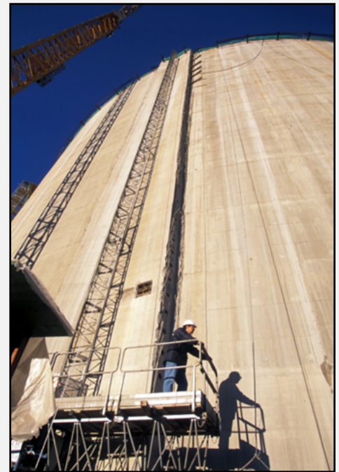
Figura 6 - Grandes tanques industriais com presença de recalques diferenciais.
