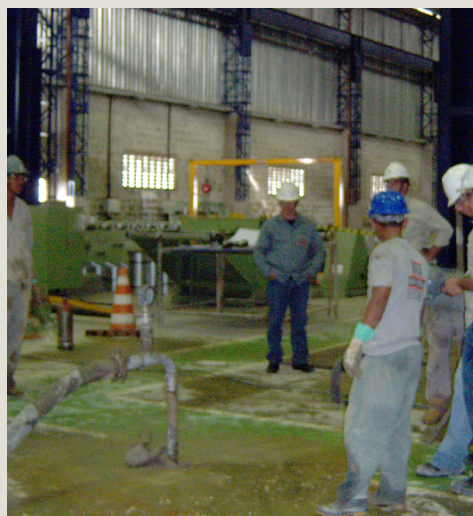
Figura 4 - ...Um ano e meio depois, grandes deformações transversais, no radier, chegaram a 50 cm, paralisando a ponte rolante. Foi necessário o melhoramento do solo, de modo a torná-lo compatível com seu sistema de fundação.
