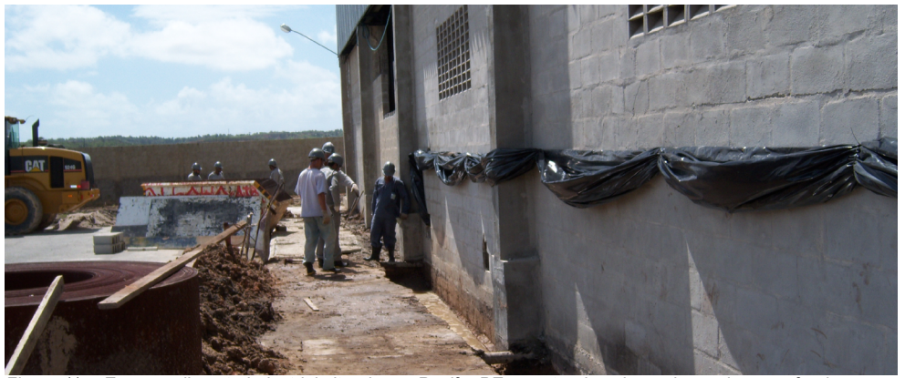
Figura 11 - Empreendimento industrial situado em Recife, PE, construído sobre solos moles com fundação em radier para tensões de 3\text{kg/cm}^2 . Recalques diferenciais...
