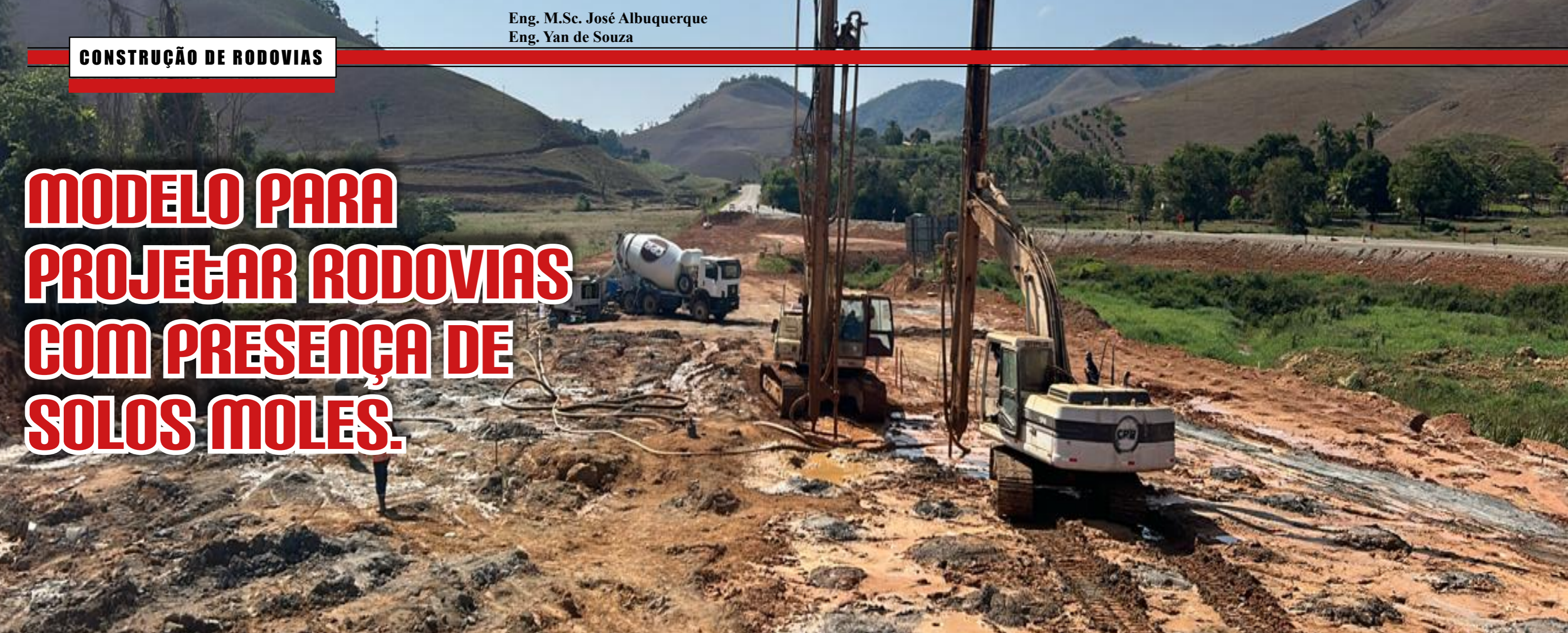
Fig - 1 - Melhoria do solo de fundação para construção de estrada no interior do estado de Minas Gerais.
