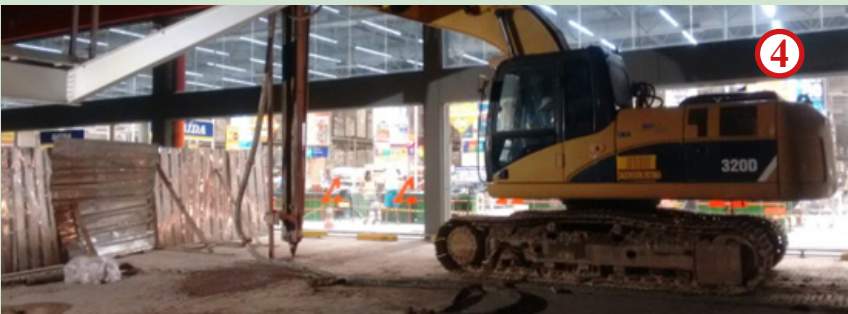
Figura 6– Estacionamento de uma rede de Supermercados construído sobre solo mole em Recife. O pavimento sofreu recalque diferencial, com valores que chegaram a 60cm, causando verdadeiras lagoas quando chovia. Foi realizado melhoramento do solo para estabelecer a rigidez necessária ao solo de fundação. Na sequência: 1) O grande estacionamento não coberto; 2) O estacionamento coberto e 3) O melhoramento do solo fora e 4) Sob o estacionamento coberto.
