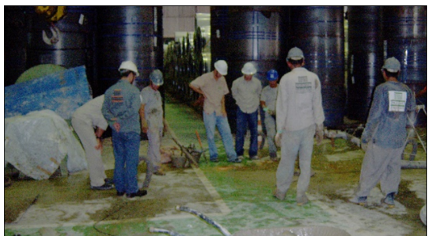
Figura 4 – Neste depósito de bobinas de chapa metálica, o projetista idealizou um espesso radier, duplamente armado para suportar (sem deformações) tensões da ordem de quase 3\text{kg/cm}^2 . A questão é que havia 20m de solo mole abaixo. O radier deformou, seguindo o solo mole abaixo, até o momento em que começou a desaprumar os pilares, paralisando a ponte rolante. O aumento da rigidez do solo, assim como sua resistência, foram obtidos com melhoramento do solo, utilizando-se o geoenrijecimento.
