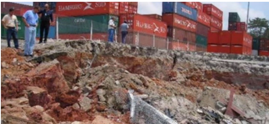
Fig 12- Rutura em um talude junto ao Rio Negro, em Manaus.
