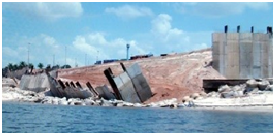
Fig 2 – Cortinas estaqueadas, em região portuária de Manaus. Técnicas localizadas de contenção não se sustentam nos taludes amazônicos.
