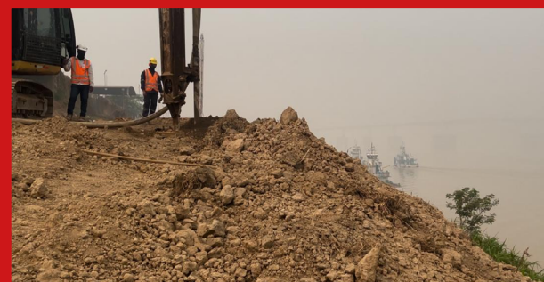
Fig 1- Melhoramento do solo com geoenrijecimento em um talude fluvial, em estado de pré-rutura, após correção da plataforma com aterro de conquista. Monitoramento prévio da poropressão, seguido de cravação de geodrenos e a conseqüente dissipação. A seguir iniciou-se trabalhos de geoenrijecimento.
