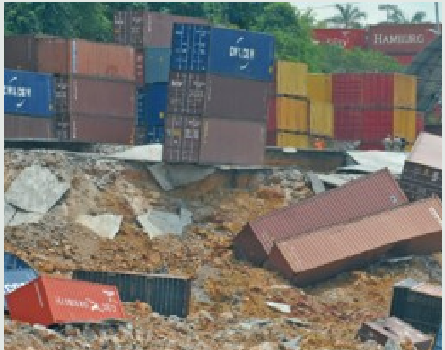
Fig 10 - A rápida e intensa variação da altura dos rios da Amazônia, provoca ruturas periódicas de seus taludes ribeirinhos, particularmente os portuários.
