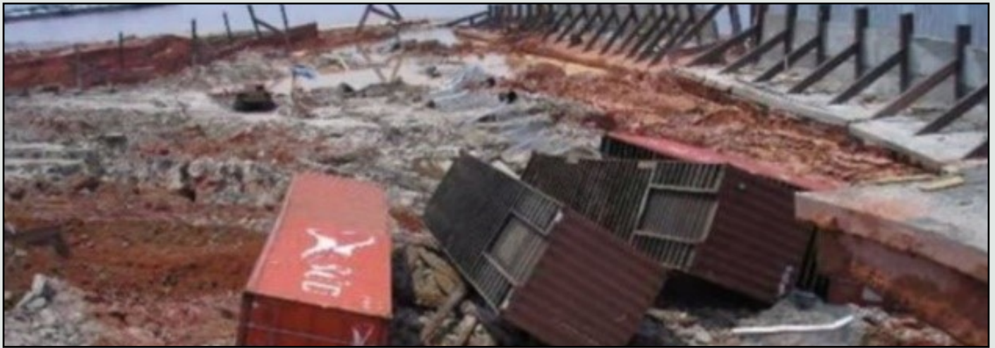
Fig 5 – Rutura por liquefação estática na zona portuária de Manaus. Um problema rotineiro que ocorre no período de vazante máxima do rio.
