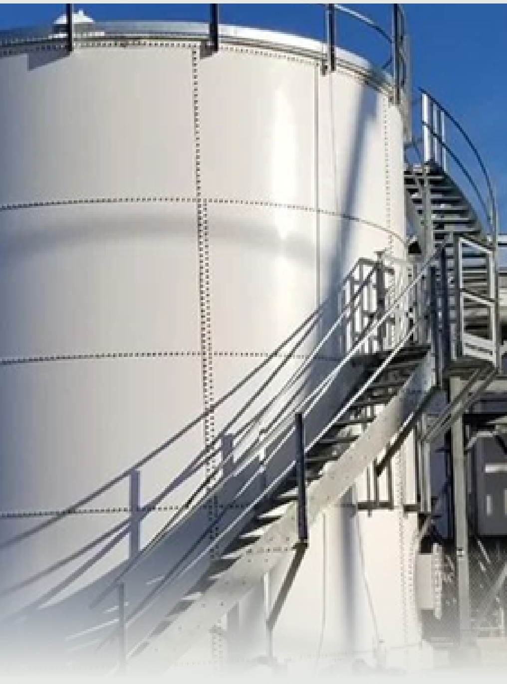
Fig. 14 - O recalque de borda situa-se junto ao costado abrangendo as chapas de fundo, o que é difícil de identificar pelo lado de fora do tanque. Por dentro torna-se mais fácil.
