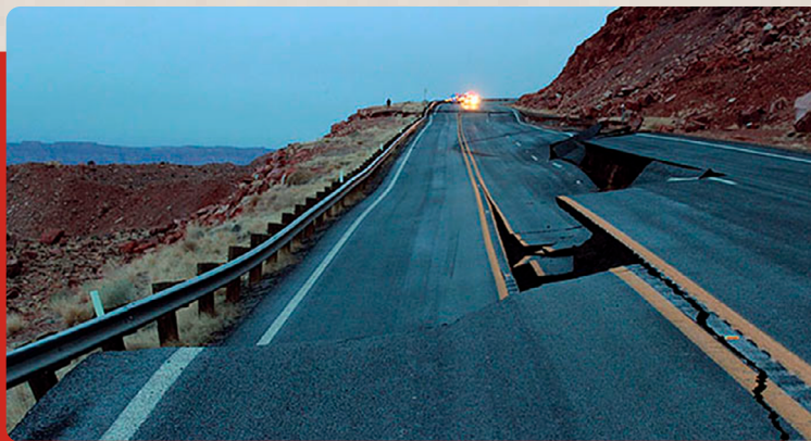
Figura 6 - Colapso do solo, sob o pavimento, após um prolongado período de chuvas.
