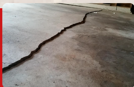
Figura 7 - Expansão do solo, neste pavimento industrial, causou levantamento do concreto.
