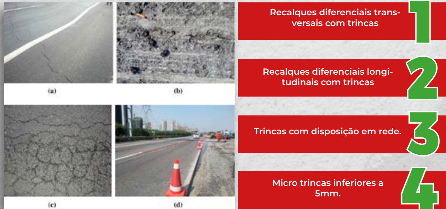
Figura 5 – quatro tipos de patologias no pavimento. a) Recalques diferenciais transversais com trincas b) Recalques diferenciais longitudinais com trincas c) Trincas com disposição em rede. d) Micro trincas inferiores a 5mm. As patologias nas faixas 3 e 4 (ampliadas) totalizam 26 e 10% respectivamente. A proporção dos problemas, nas faixas 1 e 2 (estrada original) totalizam 47 e 23% respectivamente. A proporção dos recalques, com trincas longitudinais e transversais, foi de 42 e 34%, respectivamente evidenciando tratar-se das principais manifestações patológicas. Após a surgência destas sérias patologias, o pavimento asfáltico, nestes trechos, foi trocado. Durante a remoção do pavimento asfáltico avariado, observou-se que as trincas existentes na superfície, na verdade, escondiam grande e severo processo de tensões no subleito, evidenciado por grandes aberturas e cavidades, da ordem de 10cm de profundidade e superiores a 1,50mts.
