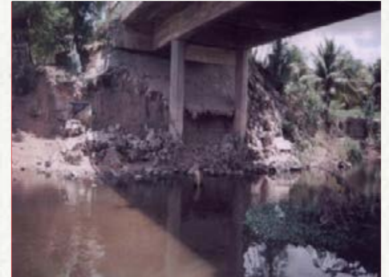
Figura 10 - Destruição do talude devido a alterações no leito do rio.
