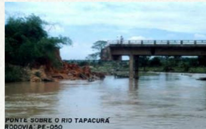
Figura 11 - Destruição total do aterro de acesso executado dentro da calha do rio.
