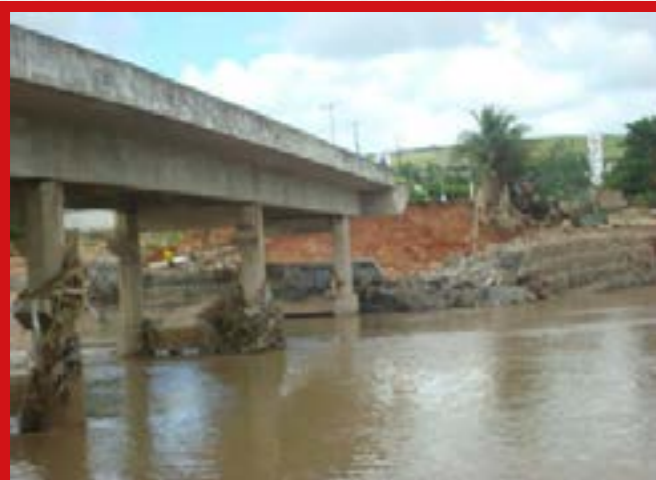
Figura 12 - Destrução dos aterros de acesso e retenção de material sólido pelos pilares da ponte.
