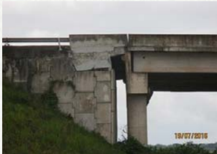
Figura 9 - Vista da contenção em terra armada com a rotação da laje de transição causada pela deformação do aterro sobre camadas de solo mole não melhorado.
