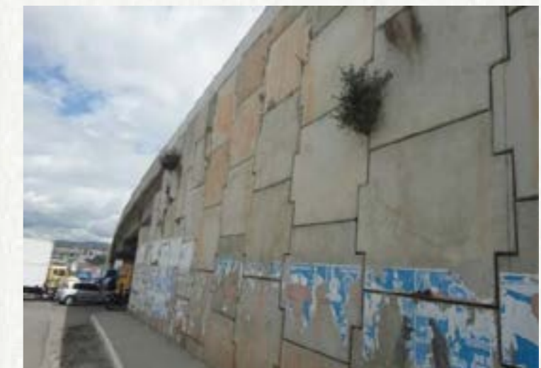
Figura 7 - Grande extensão de uma contenção de aterro de um viaduto urbano com terra armada, gerando a sensação de confinamento aos moradores das vias marginais. Observa-se também o surgimento de vegetação e outras patologias decorrentes de infiltrações e de falhas na fixação das escamas de concreto.
