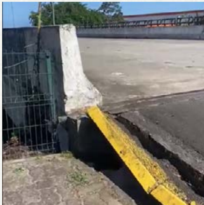
Figura 3 - Desnível acentuado entre a plataforma da ponte e a laje de transição, fraturando a mureta lateral, abrindo a junta de dilatação, expondo-a a água da chuva e erosão no aterro abaixo.
