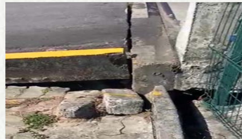
Figura 12 - Nesta outra ponte, com sete anos de vida e presença de camadas moles, que recebeu aterro de acesso, sem qualquer melhoramento prévio, sofreu sério processo de recalque, da ordem de 50 cm, causando elevada declividade na laje de transição, contornado com diversas camadas de asfalto. Sérios problemas de erosão, também.
