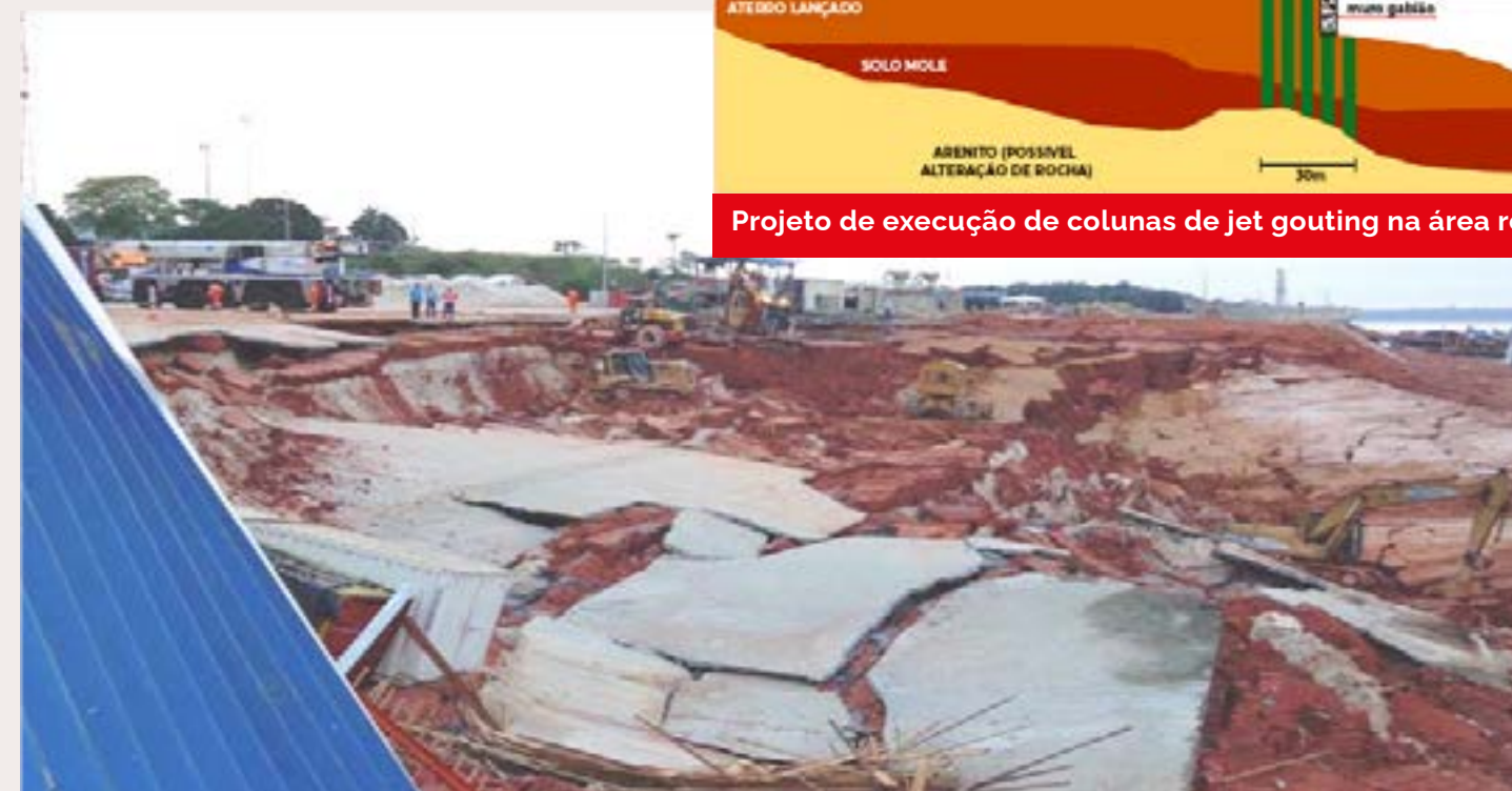
Praticamente um ano de serviços, de "recuperação da área rompida", com colunas de Jet Grouting, o solo foi novamente liquefeito. Colunas não sustentam enormes empuxos gerados por grandes campos de excessos de propressão. Os equipamentos de Jet Grouting misturaram-se ao solo rompido.
