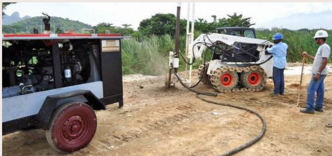
Execução de pré-furo no pavimento ensecadeira a beira da lagoa que, apesar do uso de geocomposto, como base, afundava cerca de 10 cm por dia.
