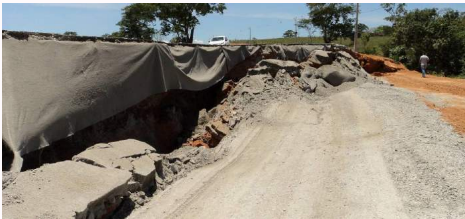
Figura 6: Grande ruptura do solo, durante a elevação de aterro para ampliação rodoviária, sem que houvesse melhoramento do solo.
