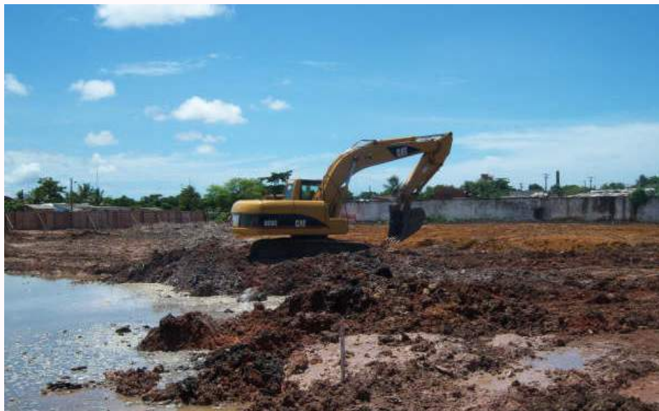
Figura 4: Área de comunidade sendo aterrada para início do melhoramento do solo com geoenrijecimento: conjuntos habitacionais
