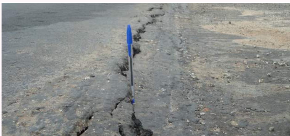
Figura 3: Trincas longitudinais, ao longo da via, em uma rodovia ampliada sem execução do escalonamento no talude original
