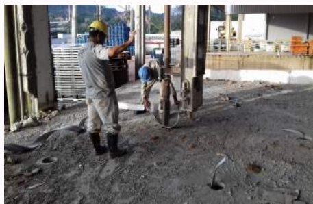
Figura 7: Aplicação de geodrenos para o geoenrijecimento do solo, com a finalidade de interromper recalques e deslocamentos laterais no empreendimento logístico
