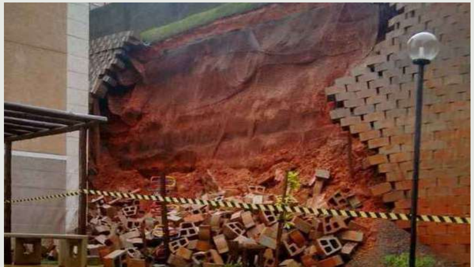
Figura 7: Delizamento pela percolação d'água à montante do corte
