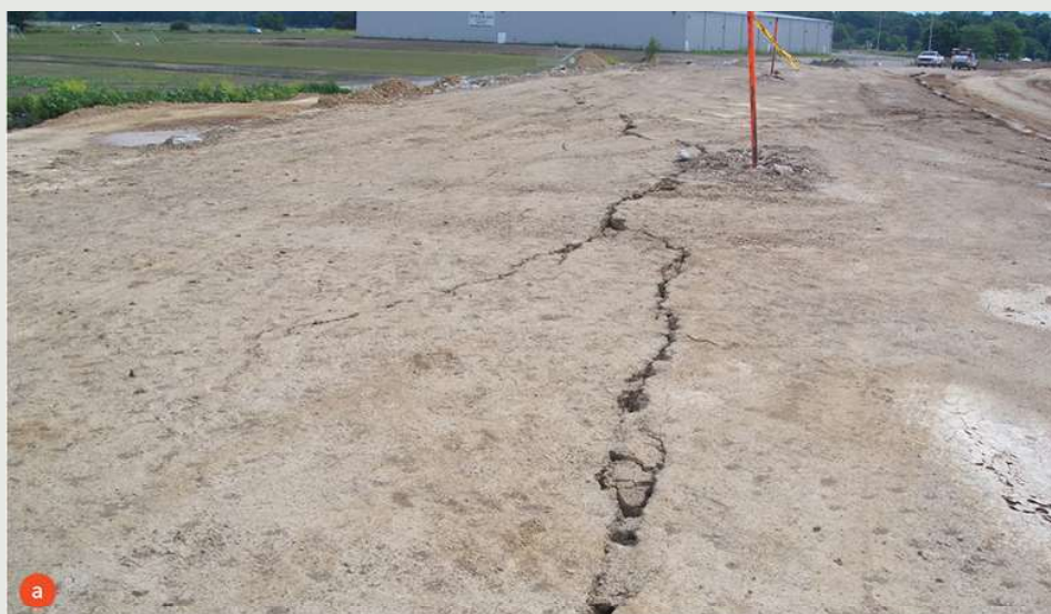
Figura 2: Trincas no aterro, à medida em que subia.
