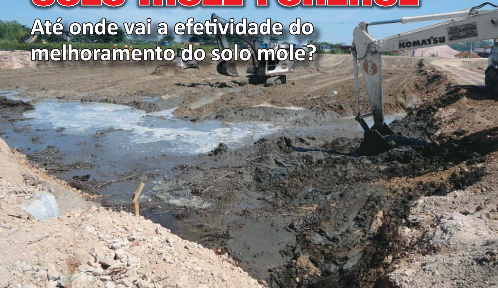
Figura 1 - A presença de solos moles em obras torna-a complexa, tecnicamente, e é cada vez mais frequente.
