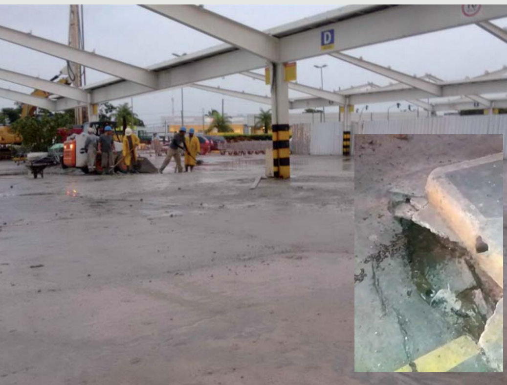
Figura 09 - Nesta área de estacionamento, semi coberta, houve recalque do pavimento de cerca de 50cm devido a presença de solo mole. Os pilares foram estaqueados, estabelecendo-se fortes recalques diferenciais.
