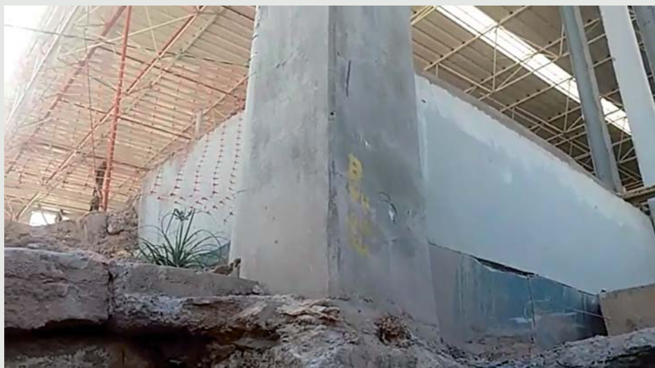
Figura 13 - Movimentação lateral do terreno desapareceu os pilares periféricos, afetando as estacas também.
