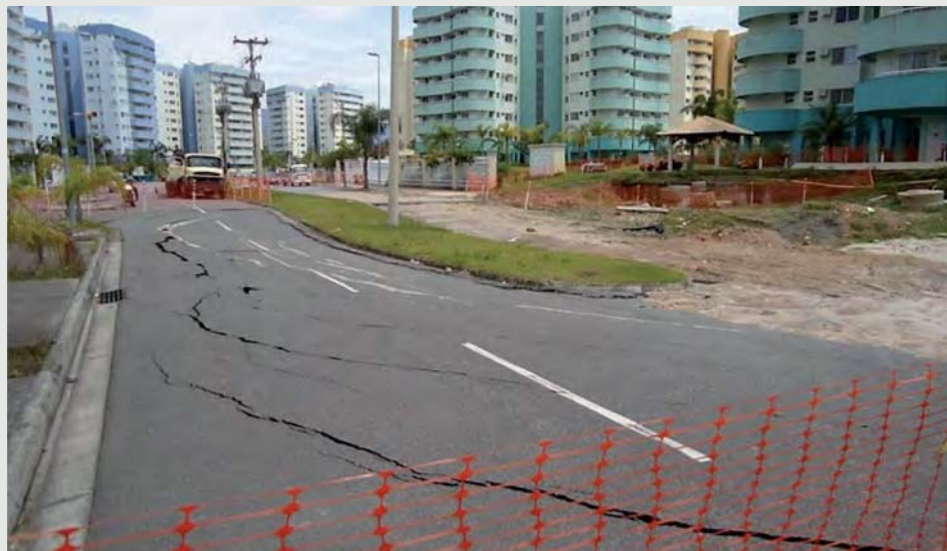
Figura 5 - Neste condomínio de prédios estaqueados, devido a presença de profundos depósitos de solos moles, dimensionou-se précarregamento e aterros estaqueados, sem sucesso, para as áreas circundantes aterradas.
