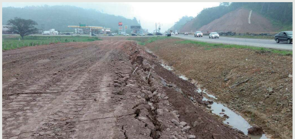
Figura 2 - Nesta duplicação, impôs-se um melhoramento de solos com pré-carregamento. A profundidade dos depósitos moles é superior a 20m, o que torna proibitivo a utilização desta técnica. O resultado são ruturas.
