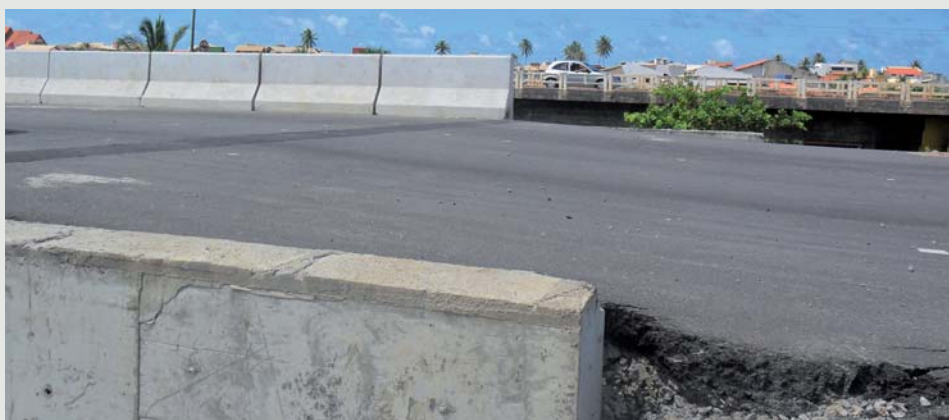
Figura 2 - A ocorrência de ressaltos, em obras geotécnicas de aterros de encontros de ponte é um problema crônico, quando há ocorrência de solo mole no local. Crônico por que, geralmente, projetam-se soluções de "melhoramento de solos" com base em pré-carregamento ou colunas, cuja eficiência é baixa e, claro, os recalques vão aparecer. Há culpados?
