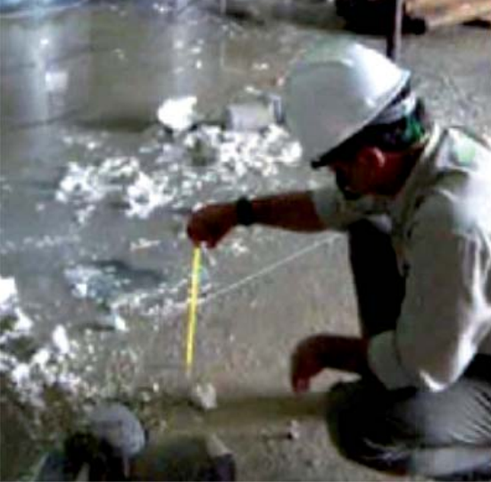
Figura 3 - Nesta indústria, o geotécnico dimensionou um robusto radier, sobre profundos depósitos de solo mole, para suportar tensões superiores a 2,5kg/cm 2 . O radier, com apenas 1 ano de uso, deformou formando concavidade com mais de 30cm em seu centro. A solução foi com melhoramento de solo com Geoenrijecimento.
