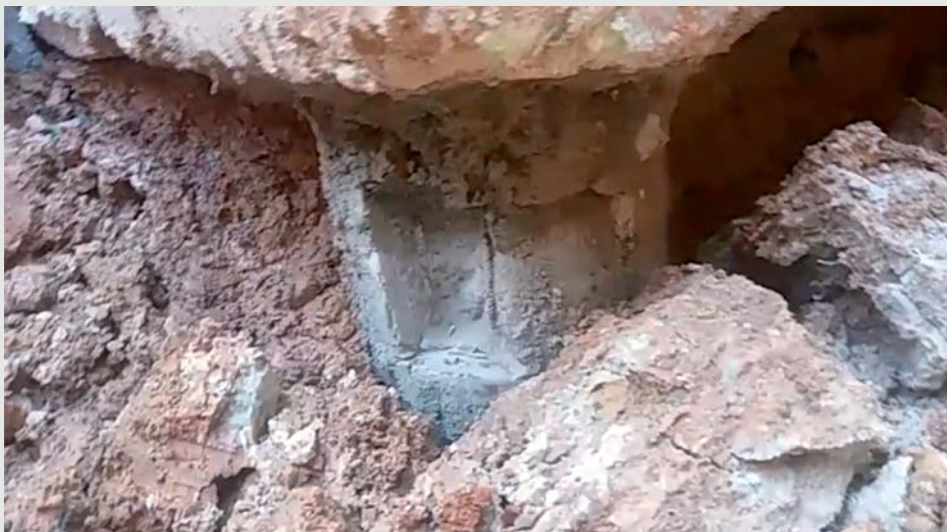
Figura 14 - A movimentação lateral fraturou a cabeça da estaca junto ao bloco.
