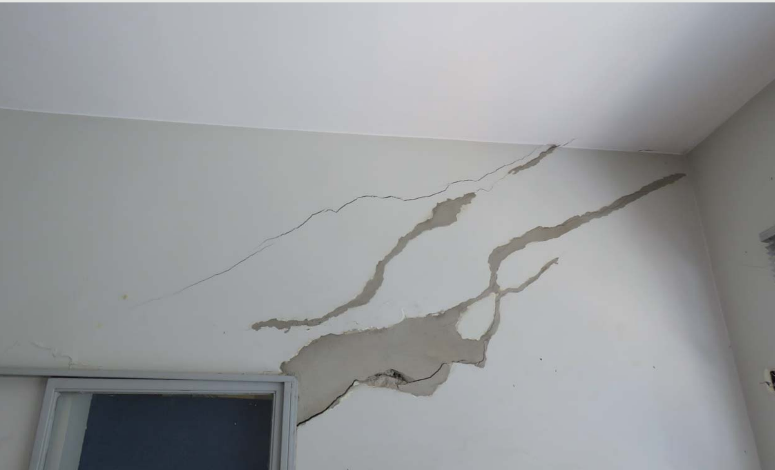
Figura 12 - Movimentação de massa horizontal e vertical do solo de fundação provocou recalques diferenciais entre pilares e piso, afetando as paredes.
