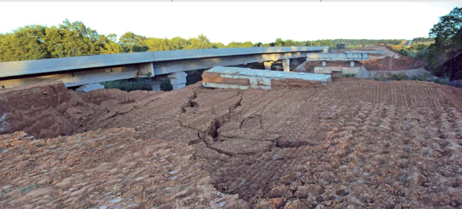
Figura 4 - Neste encontro de ponte, de uma duplicação rodoviária, projetista e construtora apostaram em levantar cerca de 4m de aterro sobre profundos depósitos de solo mole. Antes de chegar à crista de projeto, ocorreu rutura de toda a região do encontro de ponte, comprometendo os novos pilares/travessas da nova ponte. Como é possível solução tão irresponsável?
