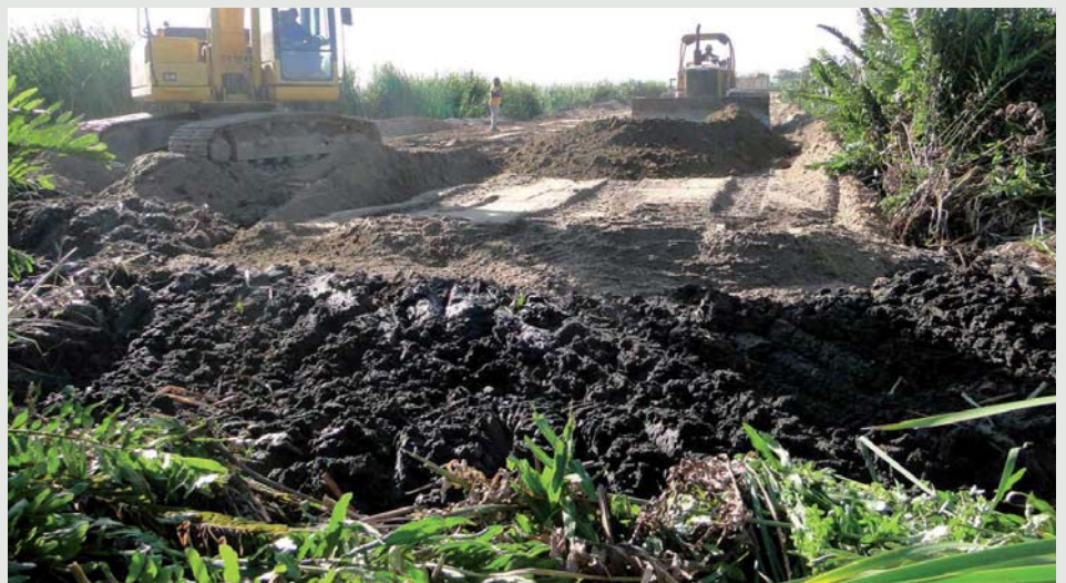
Figura 2 - A movimentação de aterro sobre solos moles é crítica e, via de regra, passa despercebida por projetistas, que só dão atenção as cargas do projeto.
