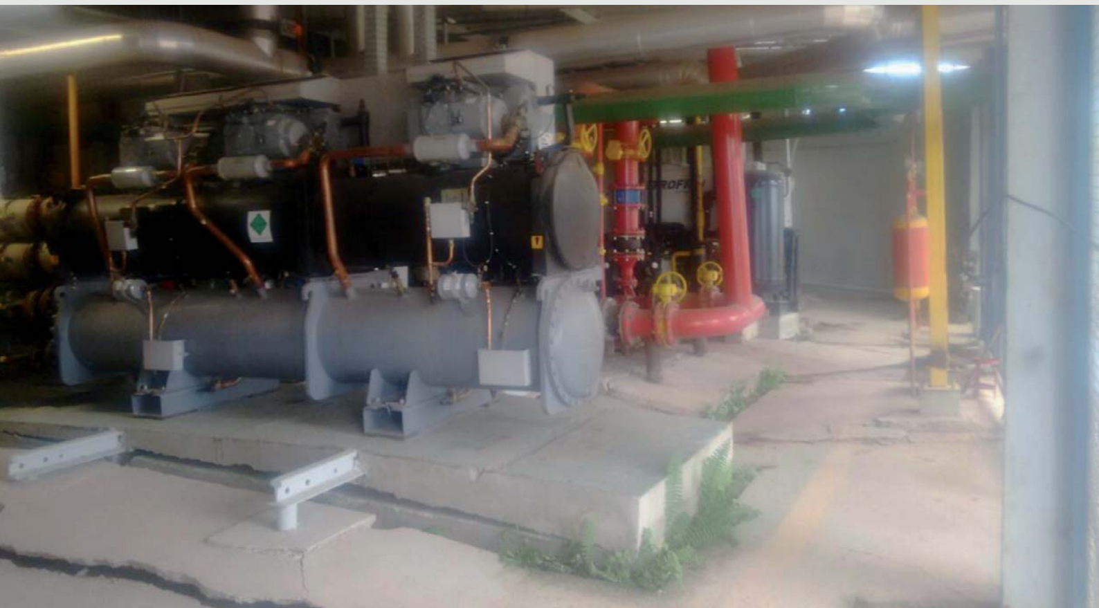
Figura 3 - Pavimento de casa de máquinas de uma grande loja com grandes recalques diferenciais em relação aos pilares, assentados sobre estacas.
