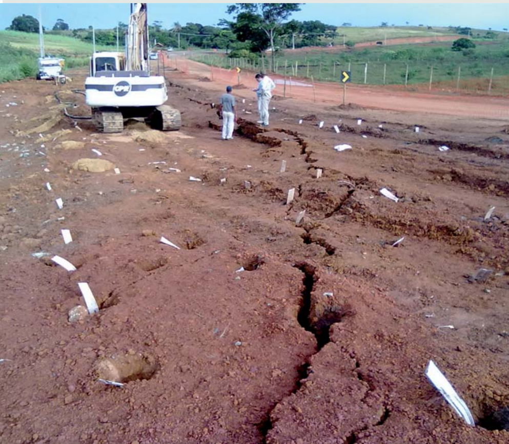
Figura 08 - Neste trecho, um início de ruptura no aterro executado para ampliação rodoviária. Trabalhos emergenciais, com o início da cravação dos geodrenos para o geoenrijecimento. A cunha de ruptura estabeleceu-se à profundidade de 5m.
