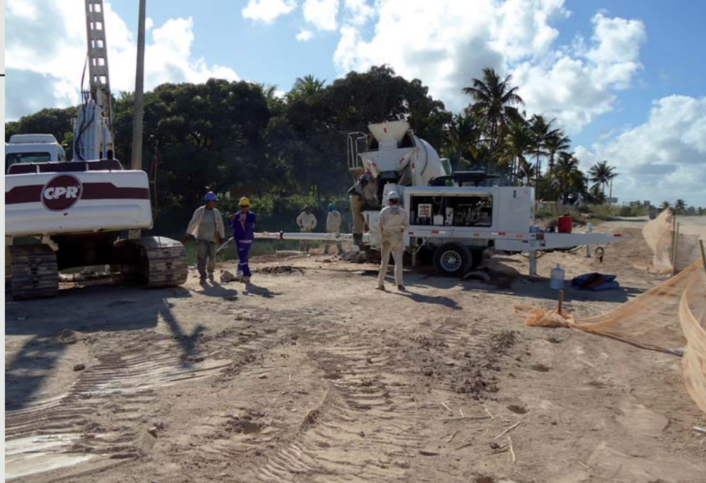
Figura 4 - Posicionamento dos equipamentos para uma ampliação rodoviária no interior do Rio de Janeiro.
