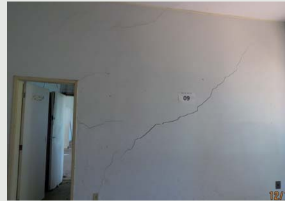
Figura 5 - Recalque diferencial manifestando-se na parede apoiada sobre fundação direta e fundação profunda (na lateral direita).
