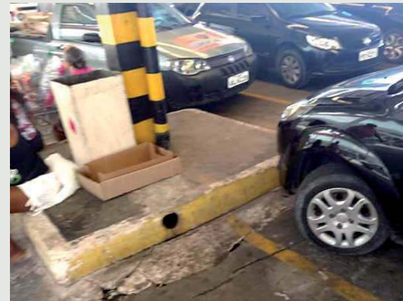
Figura 6 - Estacionamento de uma grande loja. O pavimento foi apoiado sobre aterro lançado sobre solo mole e a cobertura estaqueada. O pavimento desceu 60cm em relação a estrutura da cobertura.
