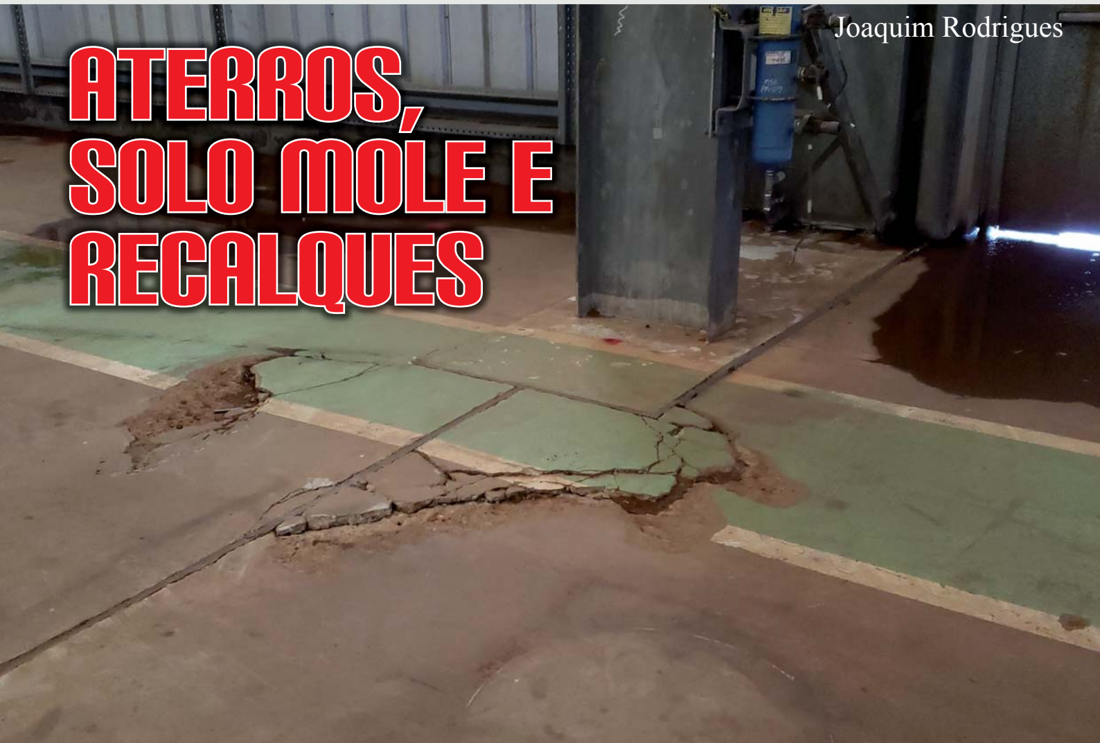
Figura 1 - Esta laje industrial está completamente apoiada em estacas premoldadas de 40cm de lado e no aterro lançado sobre espessa camada de solo mole com mais de 30m de profundidade. As estacas por sua vez apresentam recalque diferencial entre elas, motivado pelo atrito negativo. Evidentemente, o aterro recalcou também. O resultado final, são trincas e bacias na extensa laje industrial que continua recalcando.
