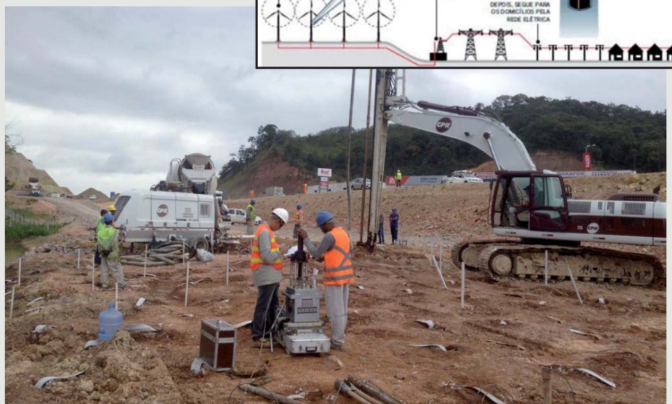
Figura 2 - Melhoramento de terreno com solo mole para execução de empreendimento no sul do Brasil.
