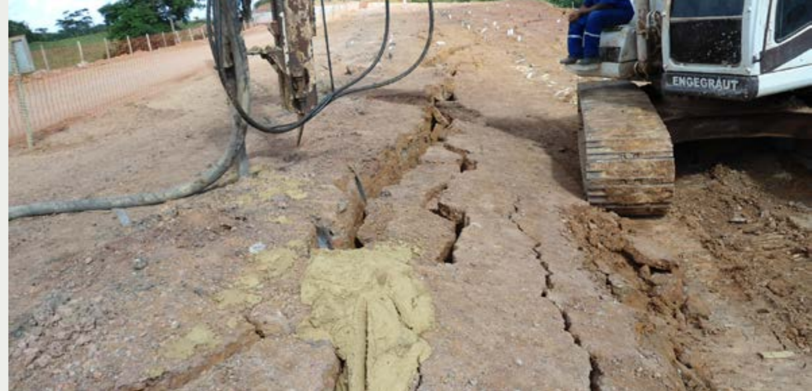
Figura 5 - Nesta obra, lançou-se e compactou-se aterro sobre solos moles objetivando-se ampliar a rodovia, sem efetivar-se qualquer melhoramento do solo. O resultado foi um extenso processo de ruptura ao longo da faixa marginal, impactando inclusive nos postes existentes. O melhoramento do solo, com Geoenrijecimento, foi iniciado a seguir, apesar de toda a instabilidade existente, com o peso dos equipamentos.
