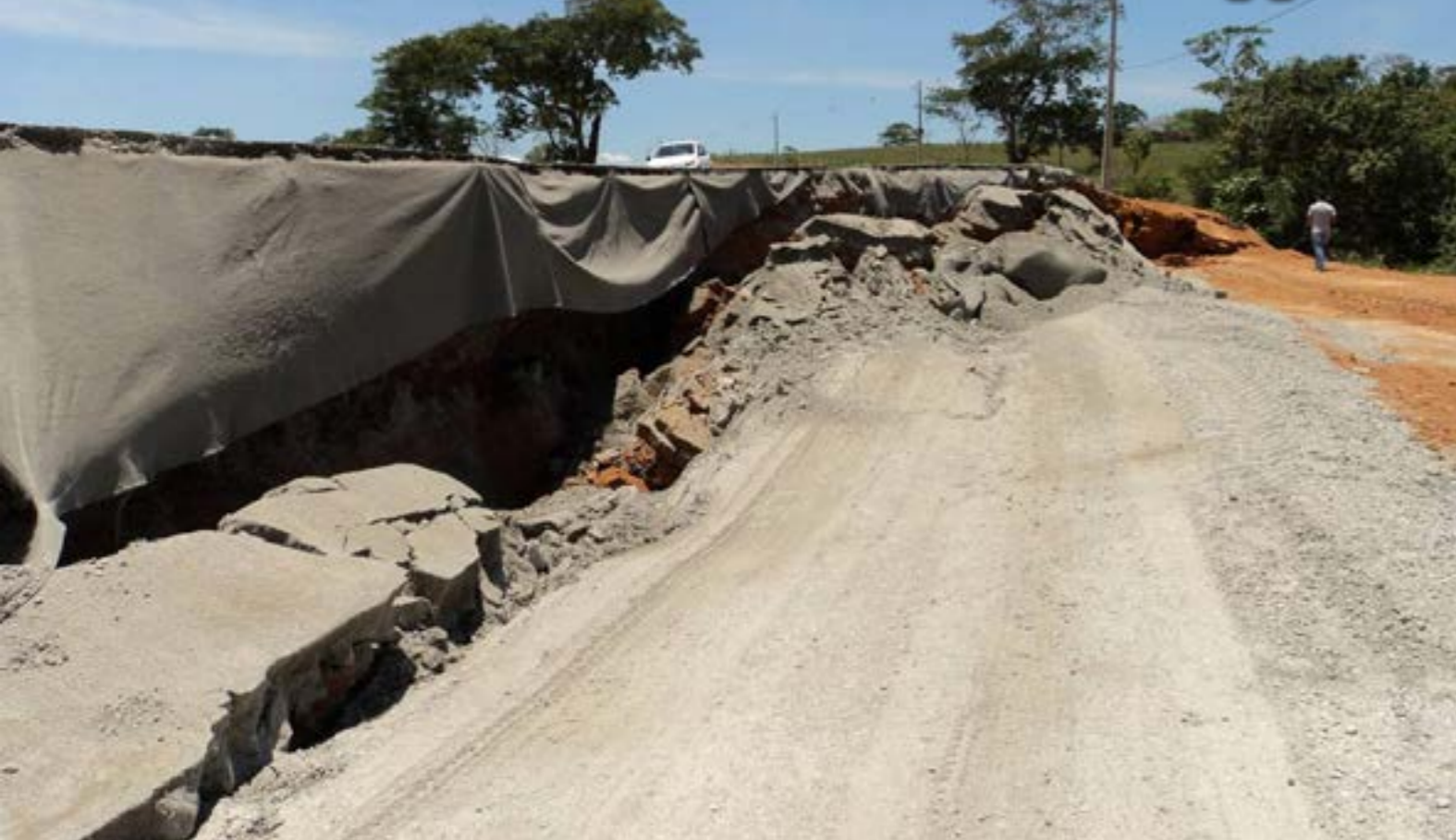
Figura 1 - Ruptura em uma ampliação rodoviária, provocada pelo uso de aterro sobre solo mole, sobre a saia do aterro antigo e faixa marginal. A ausência de melhoramento do solo foi a causa desta ruptura.
