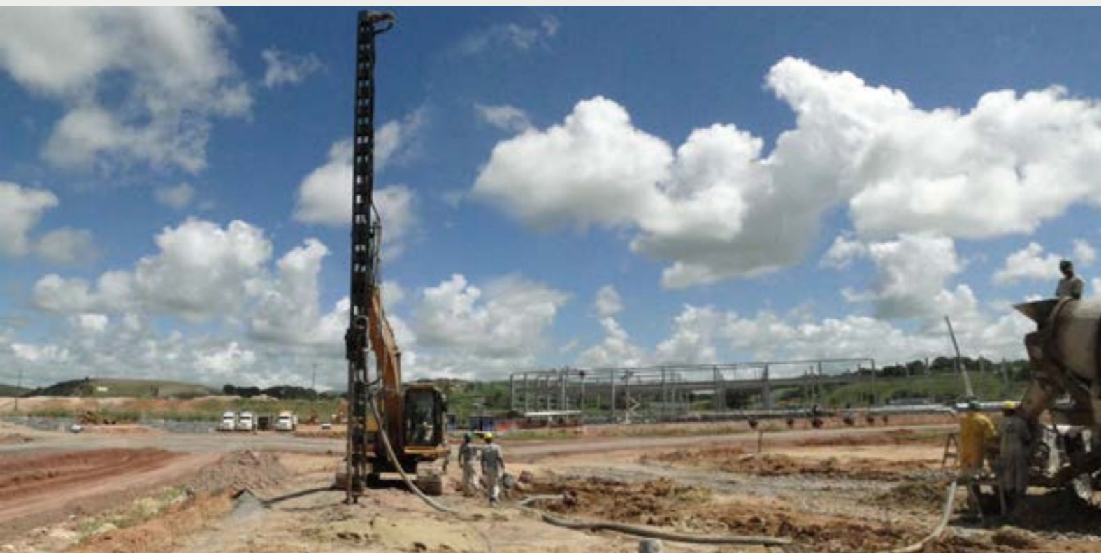
Figura 6 - Melhoramento do solo em andamento para um futuro condomínio de galpões logísticos industriais. Ausência total de recalque diferencial.
