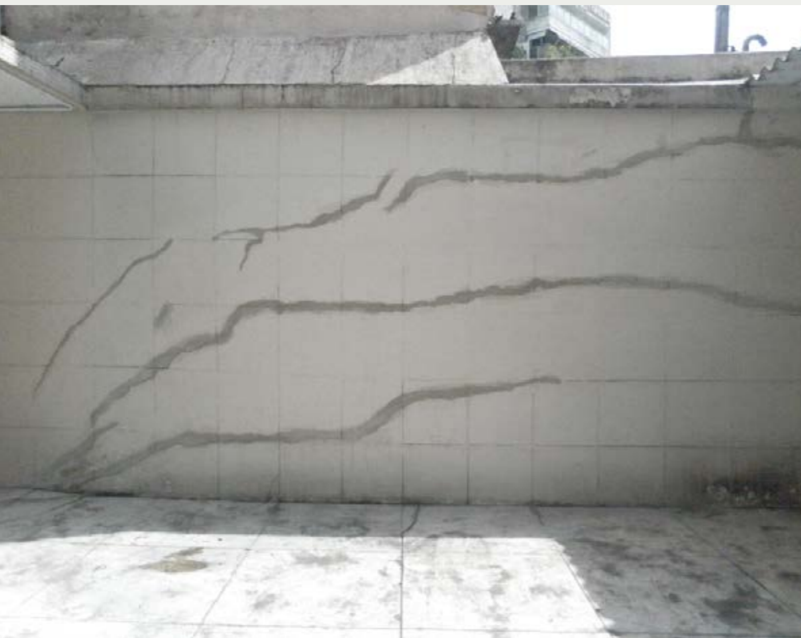
Figura 8 - Recalque diferencial, provocado em uma parede de garagem apoiada em fundação direta, em um condomínio, devido a presença de solo sem capacidade suporte, e cargas produzidas no lado do vizinho.
