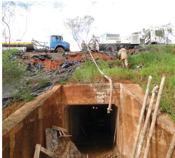
Figura 4 - A intervenção para o melhoramento do solo, com geoenrijecimento, foi feita pelo interior da galeria de passagem de gado, atuando-se pelos lados e abaixo, sem qualquer incômodo à rodovia. Havia a opção de se trabalhar pelos acostamentos, que foi descartada.
