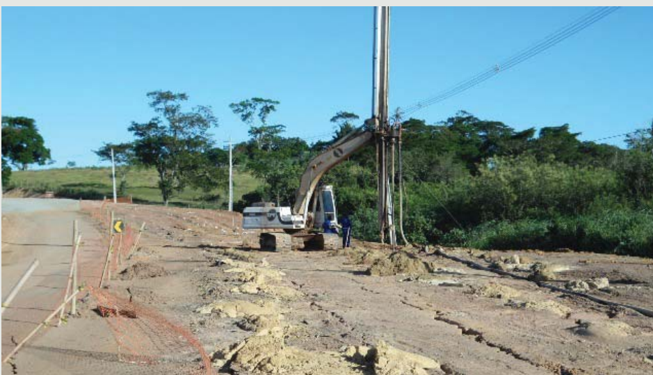
Figura 20 - Rupturas ao longo do aterro de ampliação da rodovia. O geoenrijecimento monolitiza toda a massa de solo rompida.
