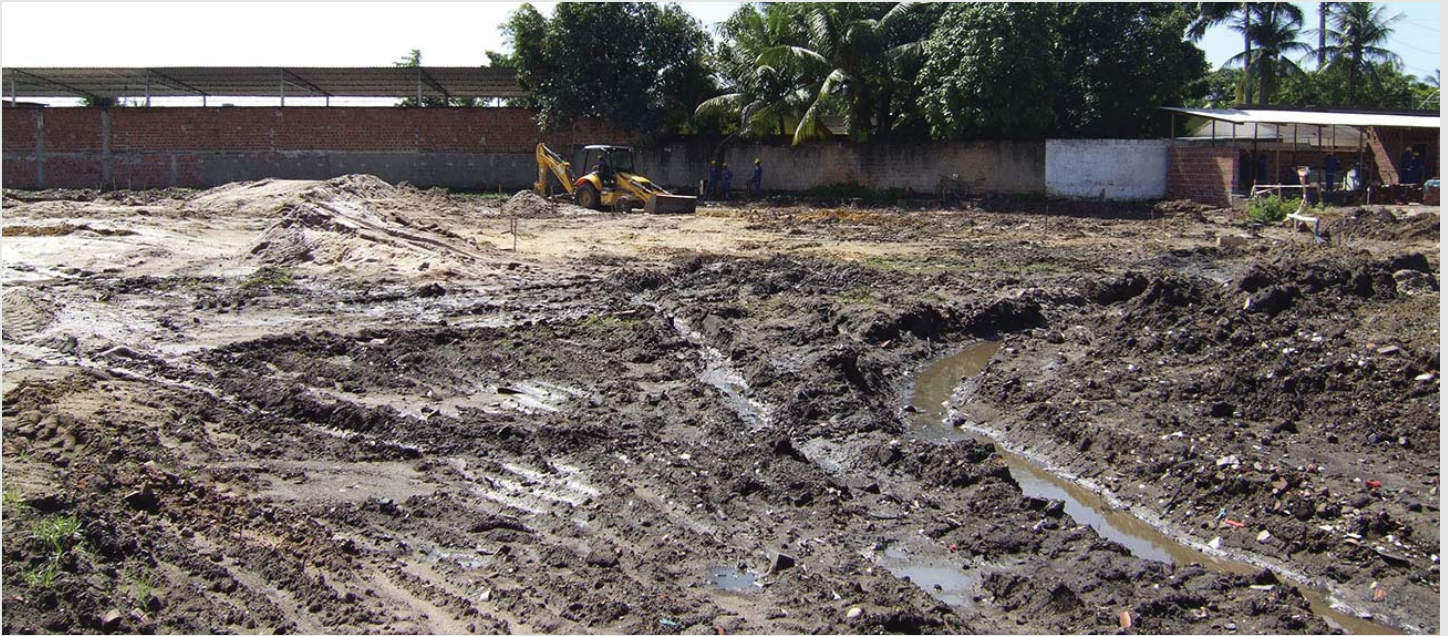
Figura 3 - Após a remoção de uma comunidade, iniciar-se-á o geoenrijecimento do solo com objetivo de construção de casas populares na região metropolitana de Recife. Presença de solos orgânicos e turfosos.
