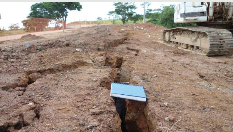
Figura 6 - Fraturas no aterro lançado sobre depósitos de solo mole em ampliação rodoviária sem melhoramento de solo.
