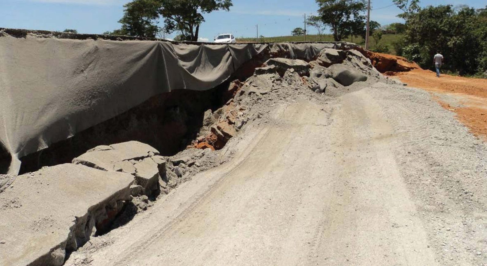
Figura 12 - Grande ruptura do solo, durante a elevação de aterro para ampliação rodoviária, sem que houvesse melhoramento do solo. Observar a condição vertical do talude devido à antiga rodovia, impossibilitando a formação do necessário escalonamento. Problemas futuros.
