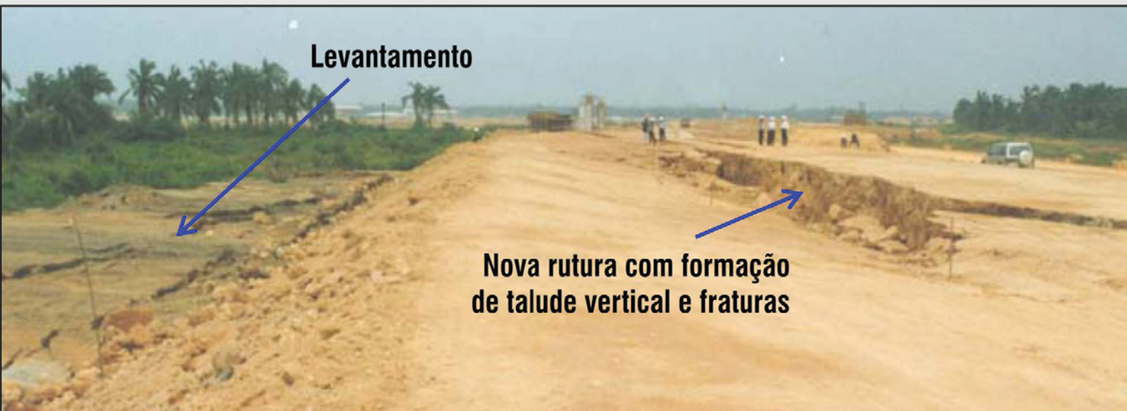
Figura 11 - Segunda ruptura do aterro, melhorado inicialmente com pré-carregamento à vácuo, utilizando-se geodrenos e, a seguir, melhorado com coluna de brita (Gue et al. 2001).
