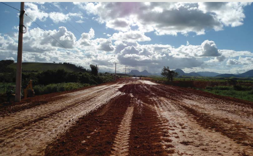
Figura 21 - Serviços finais de terraplenagem após o geoenrijecimento do solo e sua certificação estabelecendo a duplicação da rodovia pós rupturas.
