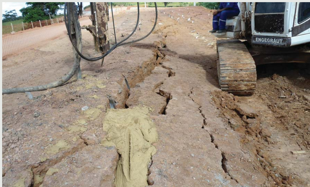
Figura 13 - A elevação do aterro rodoviário, sem qualquer melhoramento do solo mole de fundação, promoveu fraturas ao longo do aterro.
