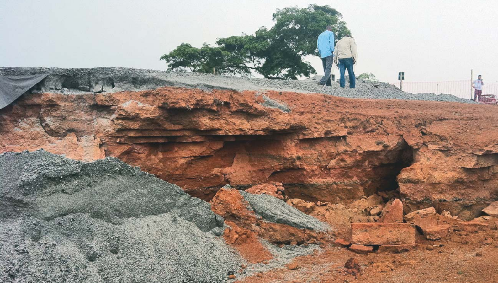
Figura 9 - Ruptura de aterro estradal, lançado sem melhoramento prévio do solo mole suporte em ampliação de rodovia. Há a formação de talude vertical na região do acostamento da antiga estrada, impossibilitando a formação do escalonamento posterior o que, certamente, irá provocar futuros problemas na nova rodovia.
