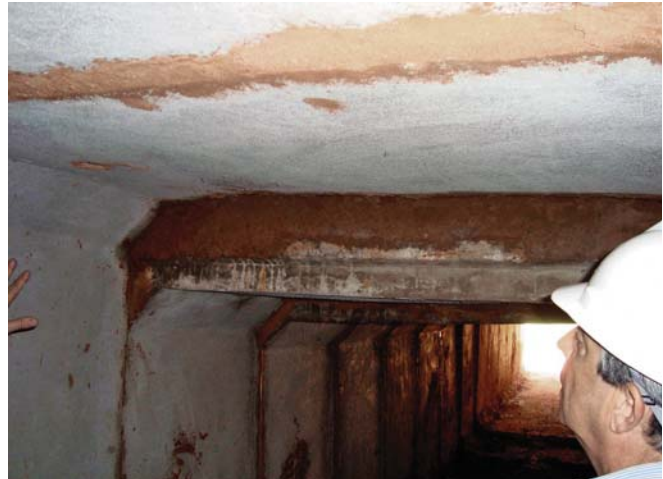
Figura 3 - O solo ao lado e sob a galeria de passagem de gado cedeu, levando parte das aduelas da galeria, provocando deformação intensa e veloz no pavimento da rodovia.
