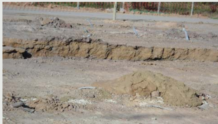
Figura 7 - Aterro estradal com processo de ruptura devido a depósitos de solo mole sem melhoramento de solo.
