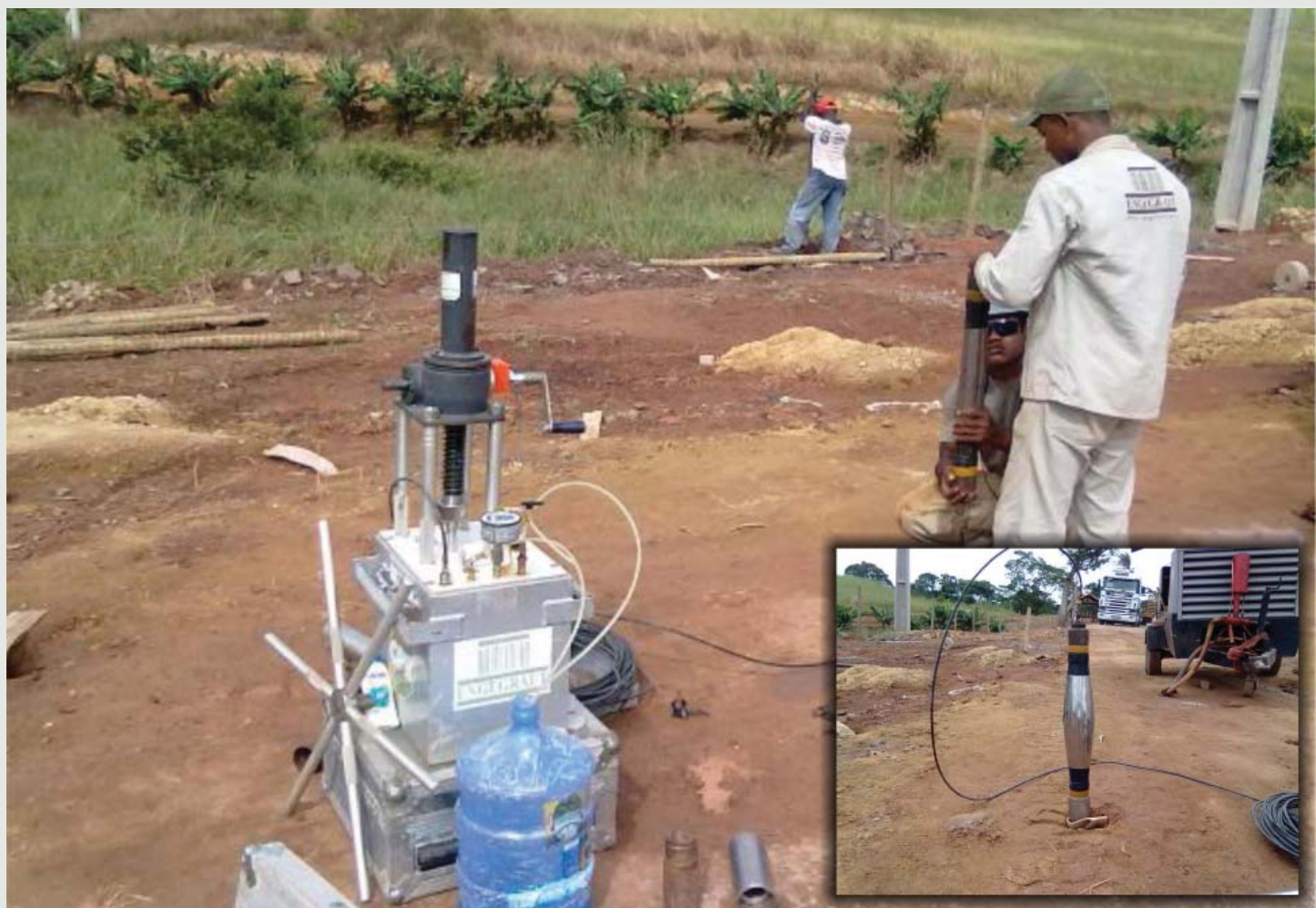
Figura 18 - Análises pressiométricas aferem a condição do solo antes e após a realização do geoenrijecimento, de modo a certifiá-lo.
