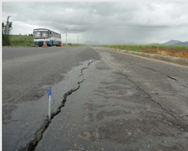
Figura 8 - Trincas longitudinais, ao longo da via, em uma rodovia ampliada sem execução do escalonamento no talude original..
