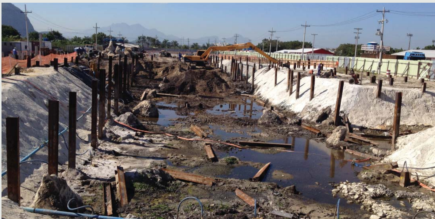
Figura 8 - Escavação em solos moles para obtenção da cota de arrasamento das estacas e construção de subsolo de edificação.
