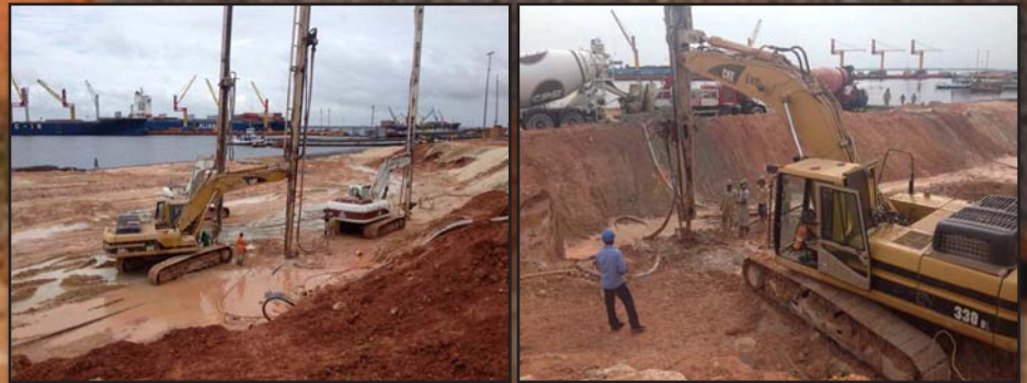
Figura 2 - Após a fase de recuperação do solo de fundação da área portuária de Manaus, colapsada pelo desastre de 2010, teve início obras de ampliação do porto, possível graças ao geoenrijecimento com CPR Grouting, com profundidades de até 30m.
