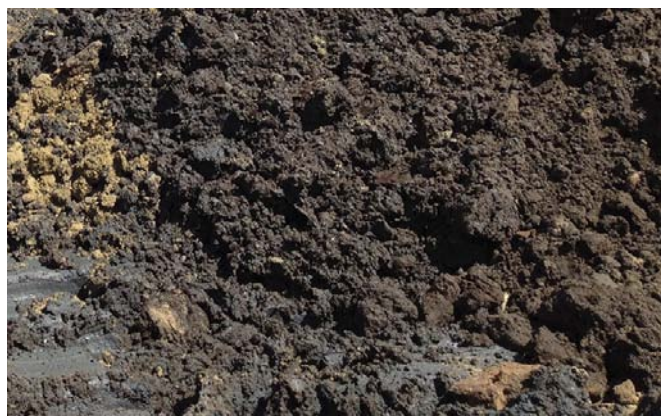
Figura 2 - É comum proceder-se o melhoramento do solo orgânico mole a partir da superfície. Para tal, necessita-se do aterro de conquista, para acesso dos equipamentos
