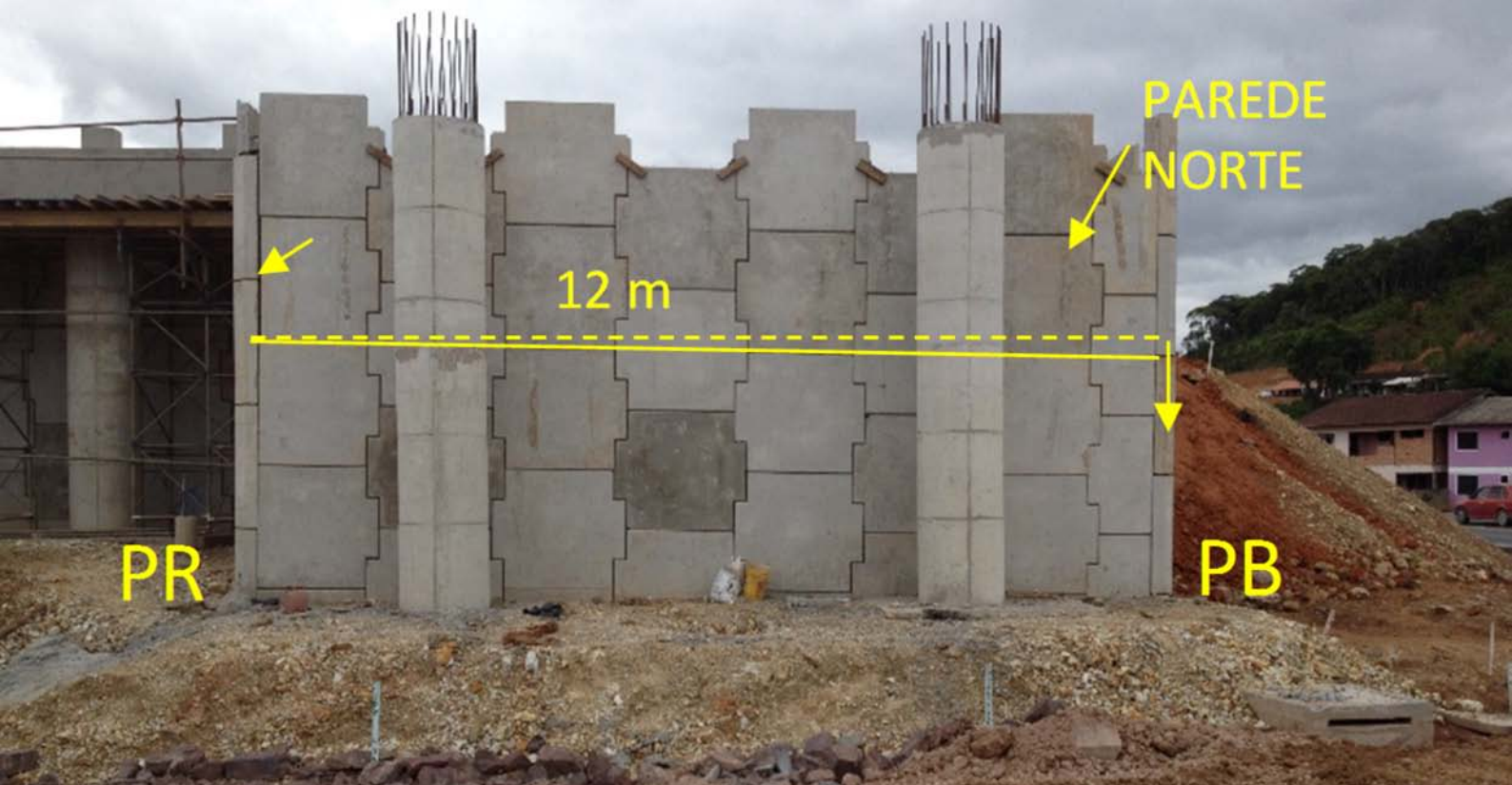
Figura 8 - Recalque diferencial entre placa de recalque e parabolts, induzindo rotação do maciço.
